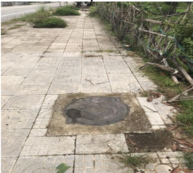
Hình 1.7. Hiện trạng thoát nước thải phía Nam dự án
