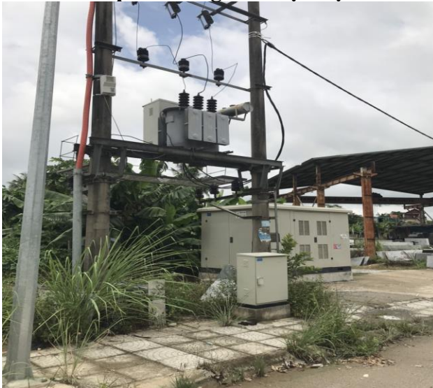
Hình 1.5. Hiện trạng cấp điện khu vực dự án
